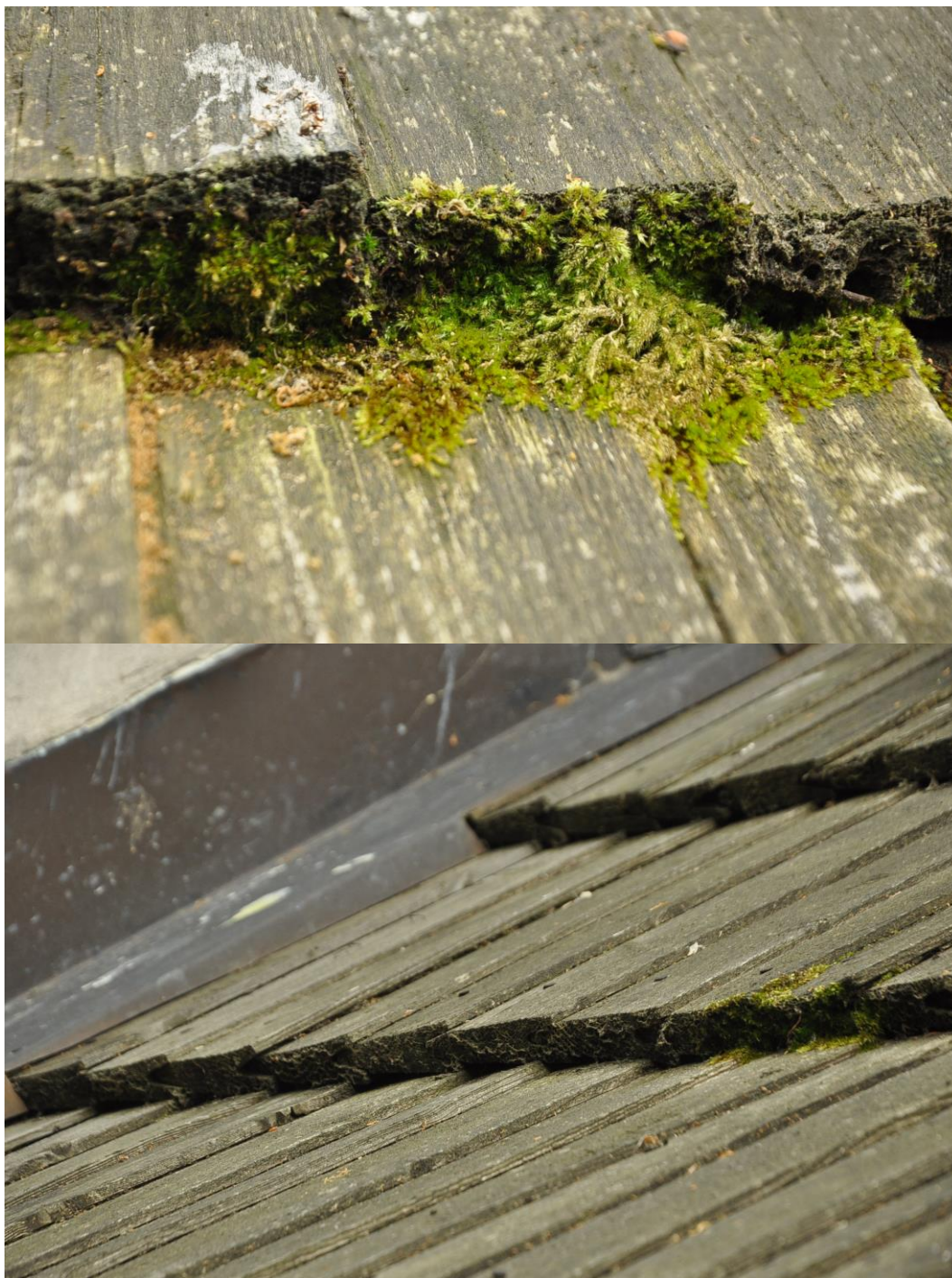
Fot.3-4. Kościół parafialny w Zbyszycach. Stan zachowania pokrycia dachowego ;grudzień 2023 r.
