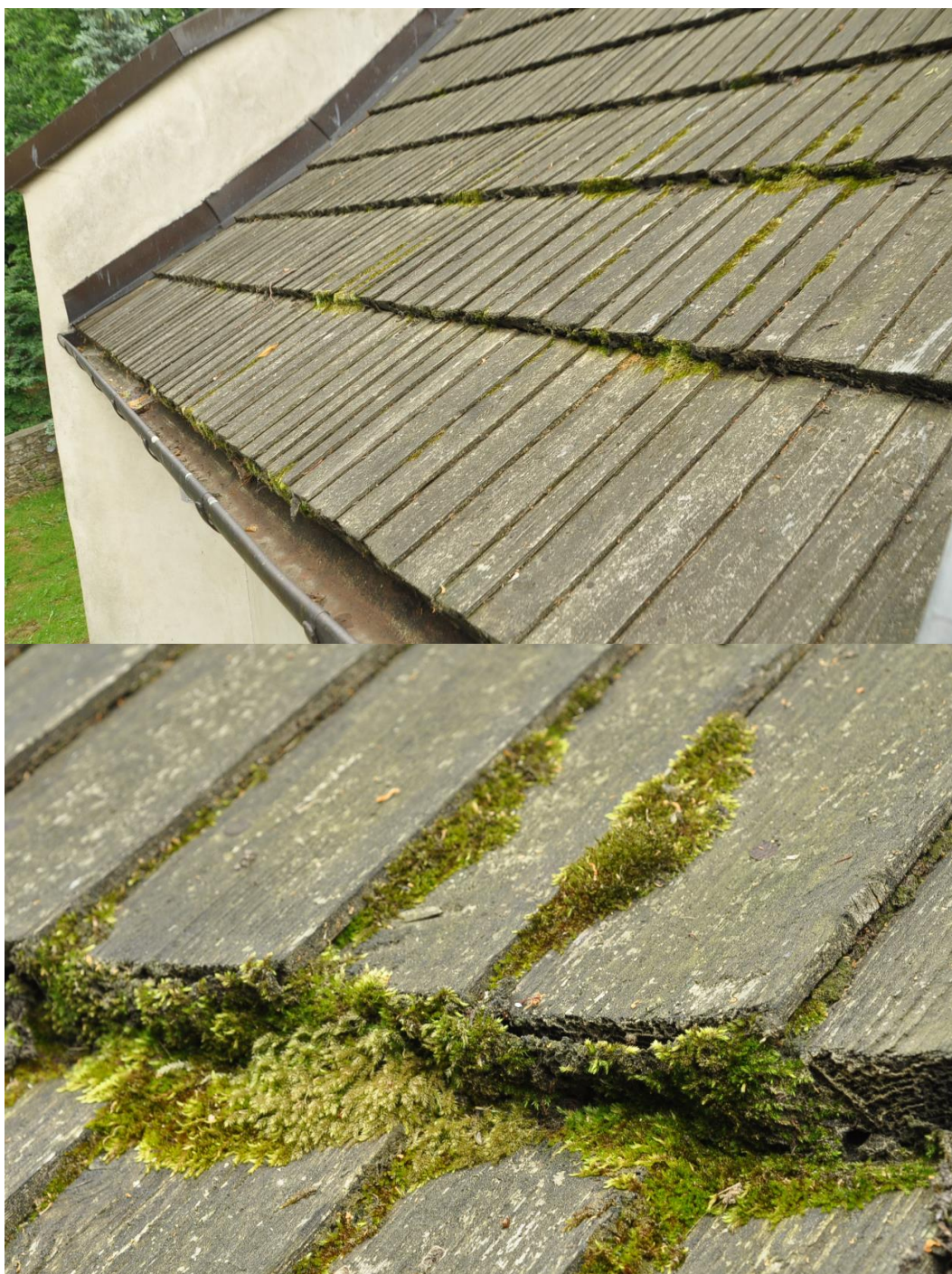
Fot.7-8. Kościół parafialny w Zbyszczach. Stan zachowania pokrycia dachowego ;grudzień 2023 r.
