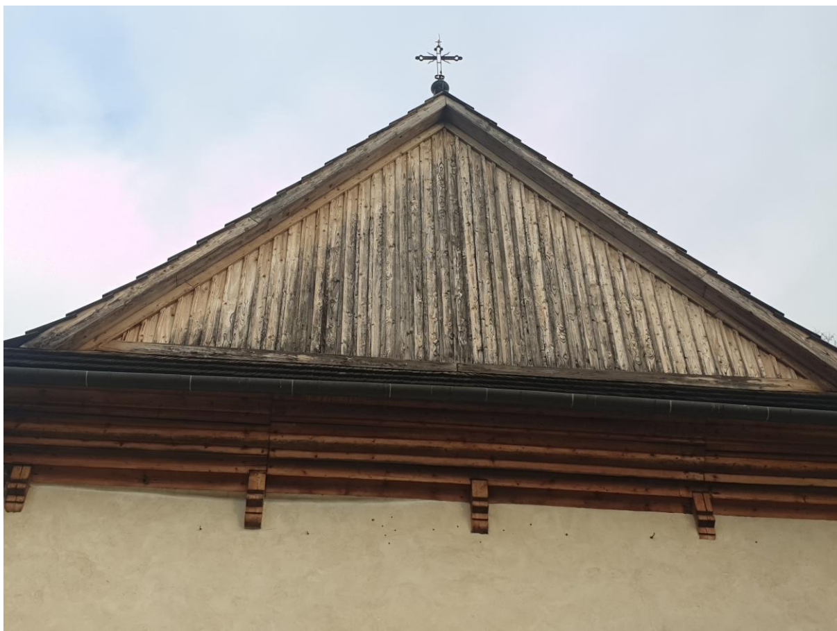
Fot.9. Kościół parafialny w Zbyszycach. Stan zachowania desek elewacji szczytowej kościoła ;grudzień 2023 r.
