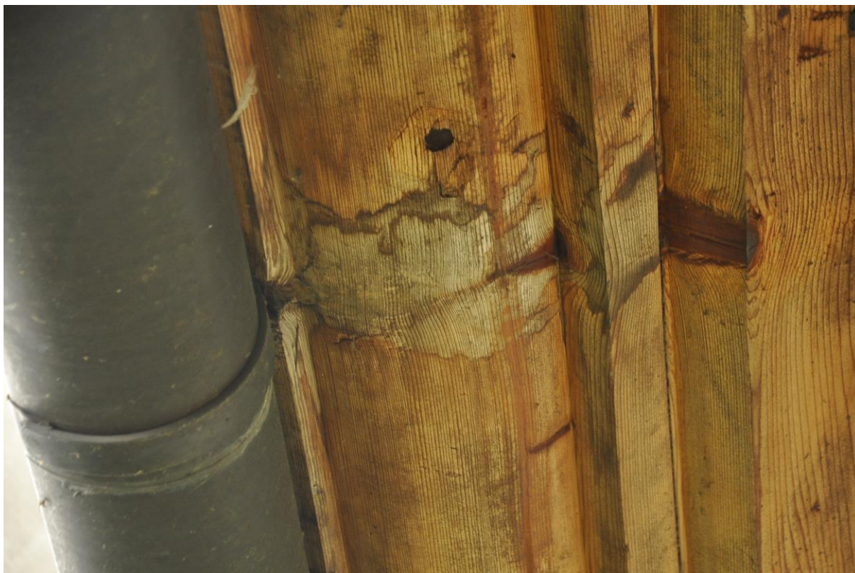
Fot.10. Kościół parafialny w Zbyszczach. Stan zachowania desek gzymsu poddachowego kościoła ;grudzień 2023 r.
